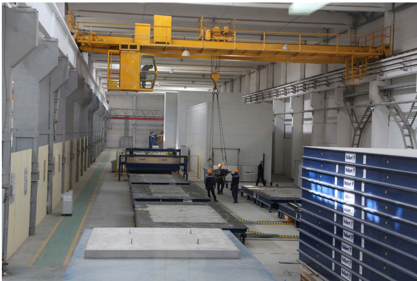
Вид на линию циркуляции паллет из операторской комнаты
