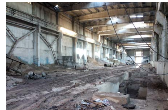
Цех циркуляционной линии Vollert до реконструкции
