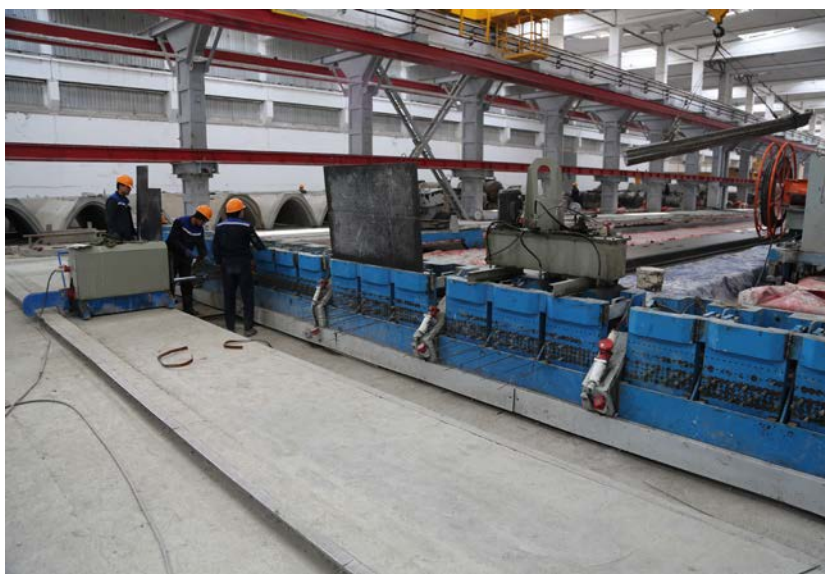
Пост натяжения проволоки линии безпалубочного формования
