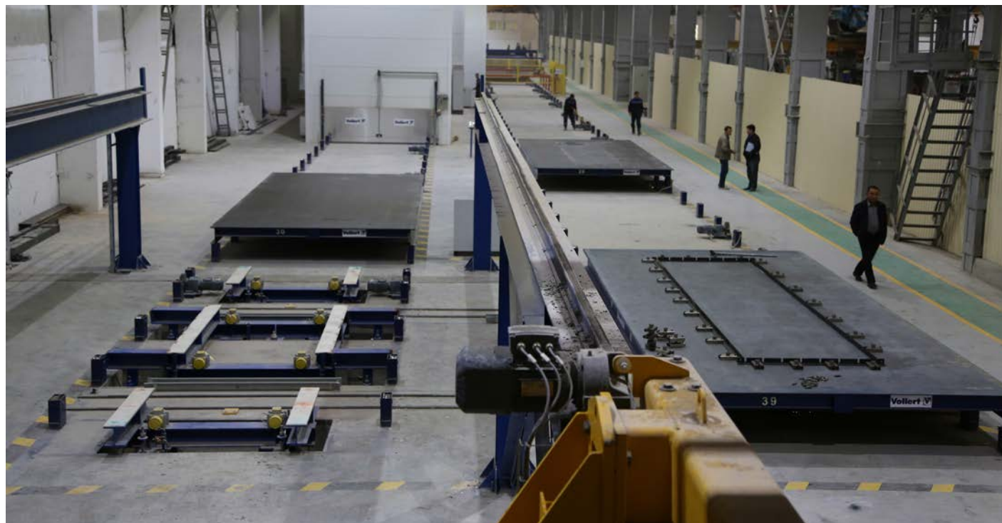
Вид на линию циркуляции паллет Vollert со стороны бетонораздатчика
